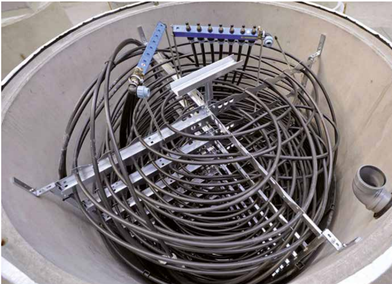
Buizenbundel in een tank
